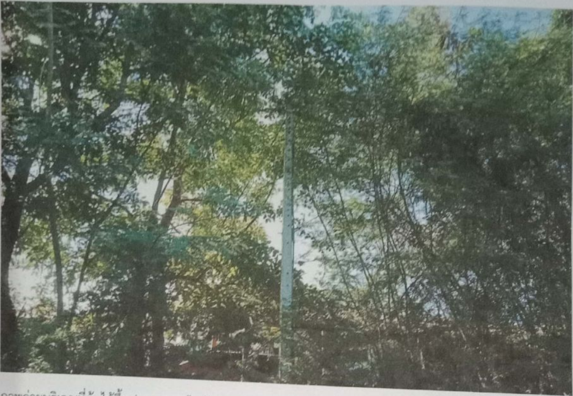
ภาพถ่ายบริเวณที่ต้นไม้ขึ้นปกคลุมสายไฟฟ้า
